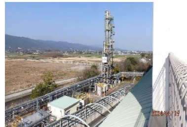
CO2回収装置（CCU設備）
